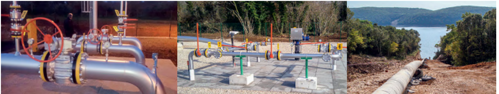
Vodnjan – Umag gas mains, Istria
