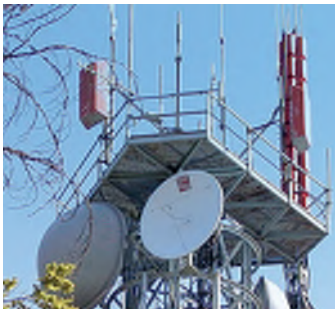
Moslavačka Gora antenna mast
